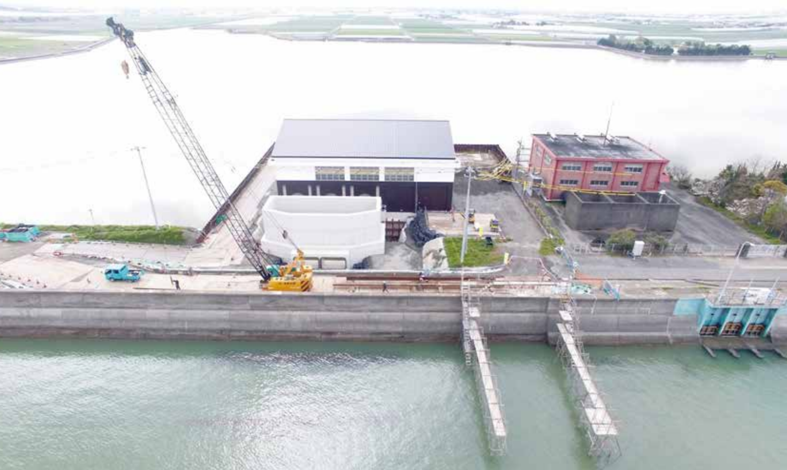
北新地排水機場（国営八代平野土地改良事業）
